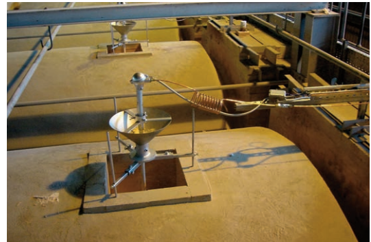
Sonden installiert auf den Regeneratoren einer querbeheizten Schmelzwanne
