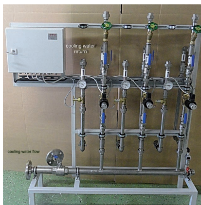
Kontrollgestell für Kühlwasser
